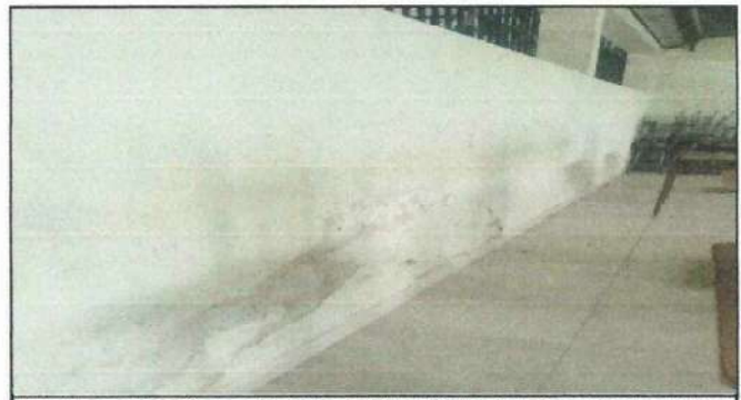
Foto 4: Paredes internas de aulas del área de laboratorios dañadas por los años del edificio, las cuales es necesarios que se restauren con los acabados que corresponda.
