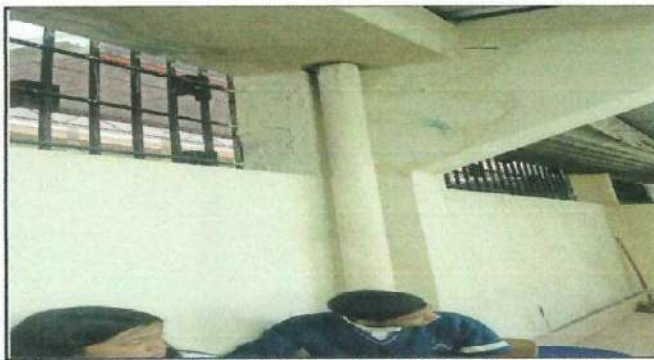
Foto 3: Las paredes internas del salón de artes industriales ha sufrido daños por lo cual deben ser restauradas con nuevos repellos y cernido en paredes.
