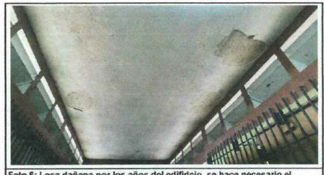
Foto 6: Losa dañana por los años del edificio, se hace necesario el remozamiento con impermeabilizantes.
