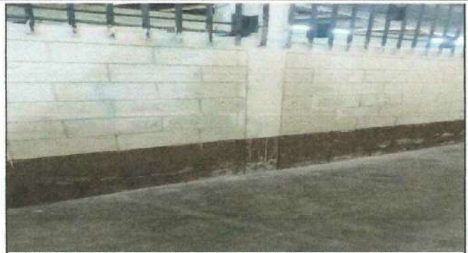
Foto 2: La paredes del salón de artes industriales se encuentra deteriorada por las constantes filtraciones de agua por lo que se deben rezanar los blocs según corresponda.
