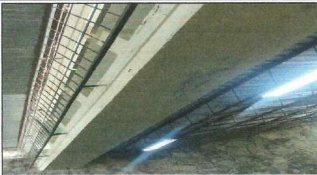
Foto 1: Canales de concreto en el área de artes industriales y hogar afectados por filtraciones de agua, es necesario resanarlos con azulejos en la parte exterior y repellandolos nuevamente donde corresponda.
